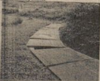
Foto 4. Canal de conducción de lixiviados. (Fecha: 23/03/2018)
