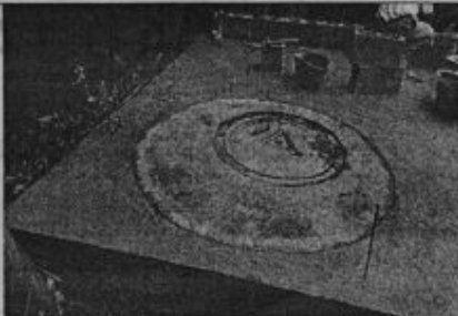
Colector localizado en la zona forestal protectora de la empresa Aguas y Aguas
