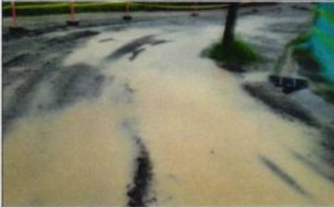
Afectación por lluvia de la vía parte alta talud
