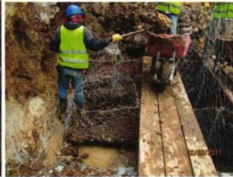
Desprendimiento terreno sobre zonas ya excavadas gavión
