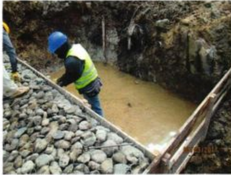
Afectación por lluvia de las zonas de excavación gavión
