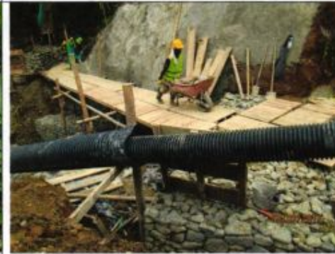
Sobre acarreo horizontal de piedra hasta el sitio de construcción de gaviones
