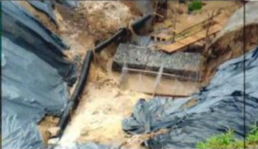
Afectación por lluvia de las zonas de excavación gavión
