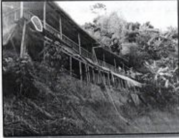
Foto 1. Vivienda en la corona del deslizamiento
