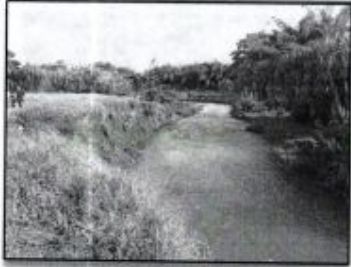
Foto 1. Aspecto del deslizamiento aguas abajo
