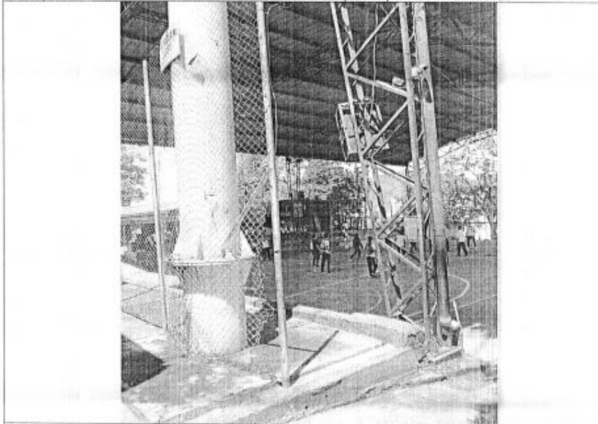
Fotografía Nro. 04: Complemento de la anterior, se aprecia con mayor claridad la instalación de la valla publicitaria.
