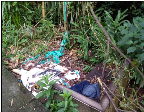
Fotografía 14. Necesidad de limpieza zona de confluencia La Arenosa – La
